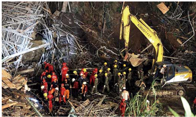
國道6號北山交流道新建工程鷹架倒塌事故現場
