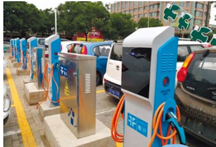
大陸「共享汽車」大多使用電動車，充電樁的建設成為關鍵因素之一。
