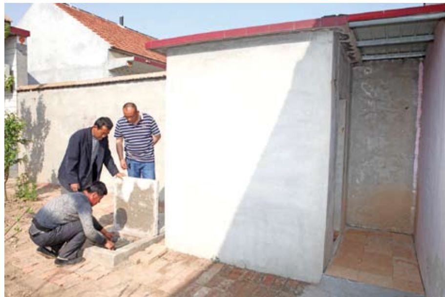
工作人員在山東省無棣縣余家鎮查看水沖雙壺式無害化衛生廁所化糞井。
